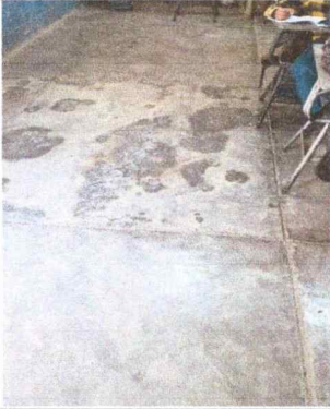
Foto 1: Se visualiza el deterioro del piso. MODULO II
