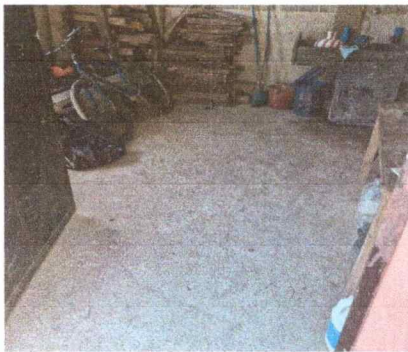
Foto 3: Se visualiza el deterioro del piso y se instalará piso cerámico para el mejoramiento de la cocina. MODULO I
