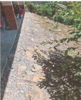
Foto 5: Se requiere mejoramiento de banqueta. MODULO I
