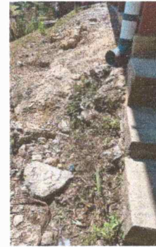
Foto 6: Se visualiza el deterioro del área, se implementará una banqueta. MODULO I
